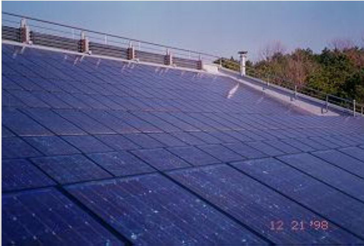
지붕에 설치된 Photovoltaic system
