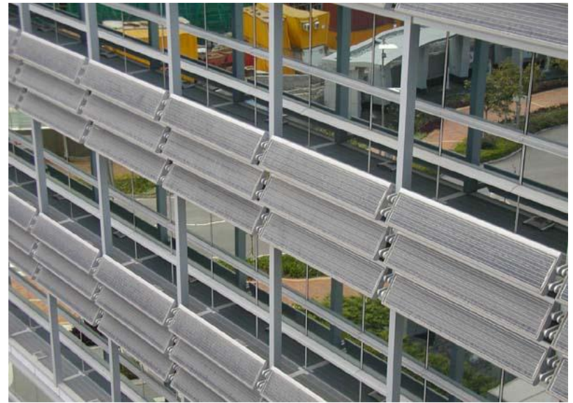
< Science Park 내 건물 외벽의 Solar Collector Array >
