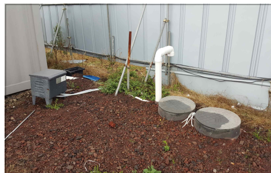
(B) 매립 설치된 정화조
