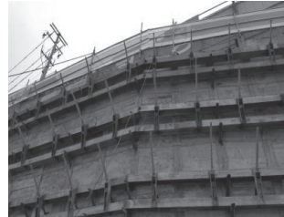
고재 H-pile 사용 및 안정성 검토 미 실시
